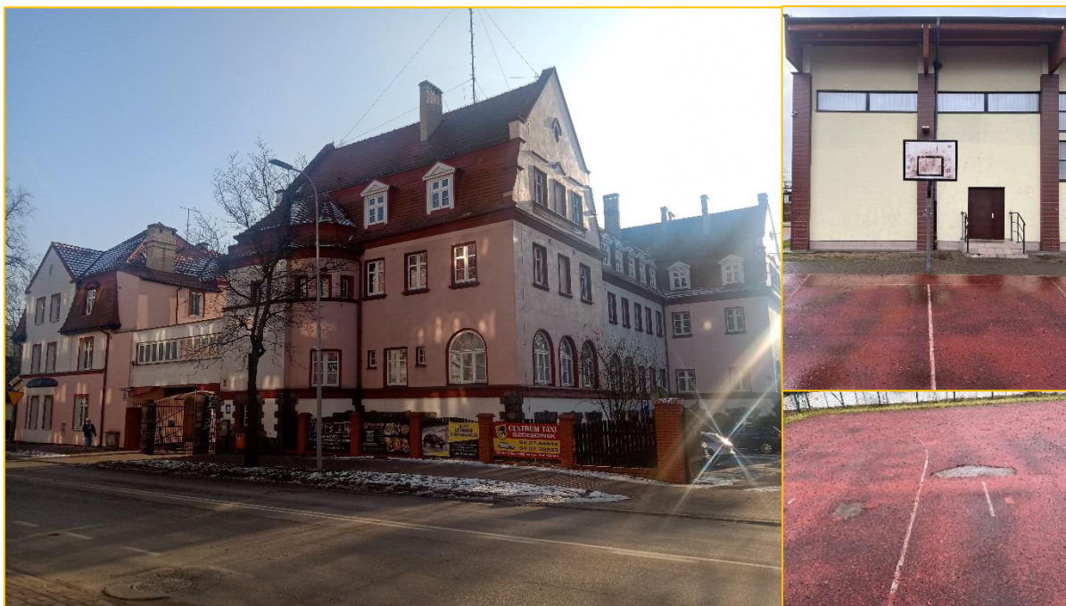
Rysunek 22. Stan techniczny wybranych obiektów użyteczności publicznej znajdujących się na obszarze rewitalizacji (1) Budynek SAPIK przy ul. Kościuszki, (2) i (3) Boisko przy ul. Jasnej.
