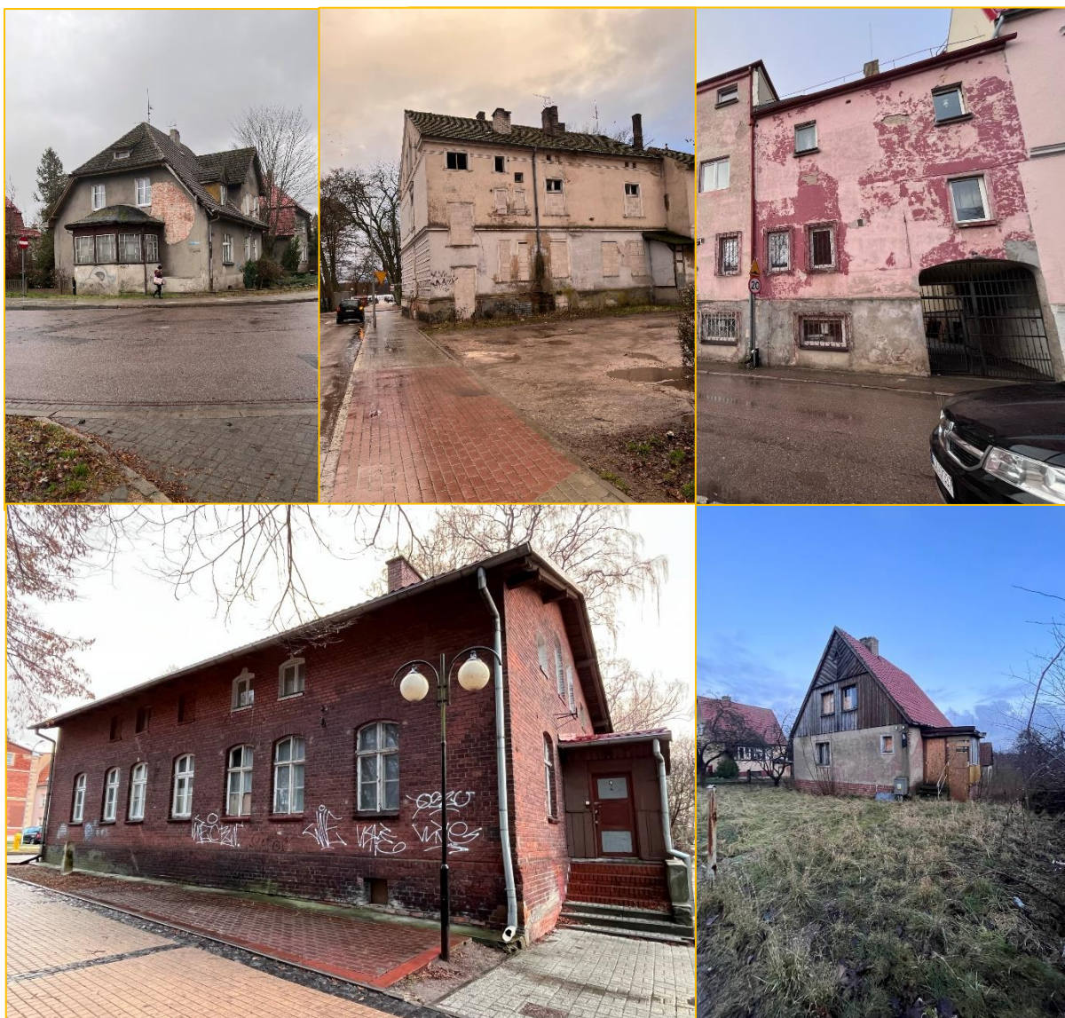
Rysunek 24. Stan techniczny wybranych budynków mieszkalnych zlokalizowanych na obszarze rewitalizacji (1) ul. Ordona 27, (2) ul. Ordona 6, (3) ul. Junacka 5, (4) ul. Ordona 3, (5) ul. Curie-Skłodowskiej 6
