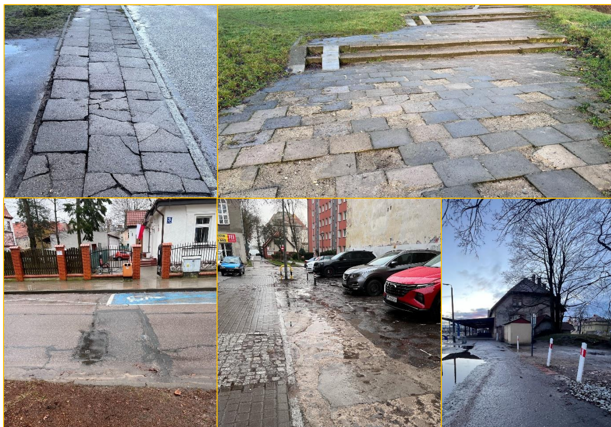
Rysunek 25. Stan techniczny wybranych nawierzchni na obszarze rewitalizacji (1) ul. Przemysłowa 7, (2) Wzgórze św. Jerzego, (3) ul. Jasna 2, (4) ul. Księżnej Elżbiety, (5) Dworzec Kolejowy.
